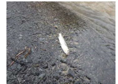
漏水箇所付近の状況
